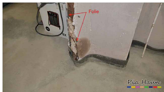
Abb. 5: Missglückter Versuch eines Bauherren mittels Einarbeitung einer handelsüblichen PE-Folie unter dem Putz als »Sperrschicht«
