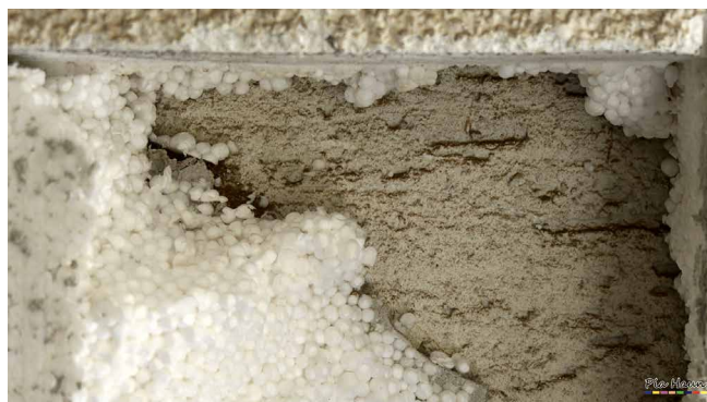
Abb. 9: Nach Entfernen der Polystyrol-Dämmung wird das eingedrungene Öl auf dem alten Putz sichtbar
