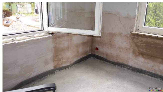
Abb. 4: Innenansicht zu Abb. 3: Raumseitig schlägt der Ölfilm durch den neuen Innenputz durch
